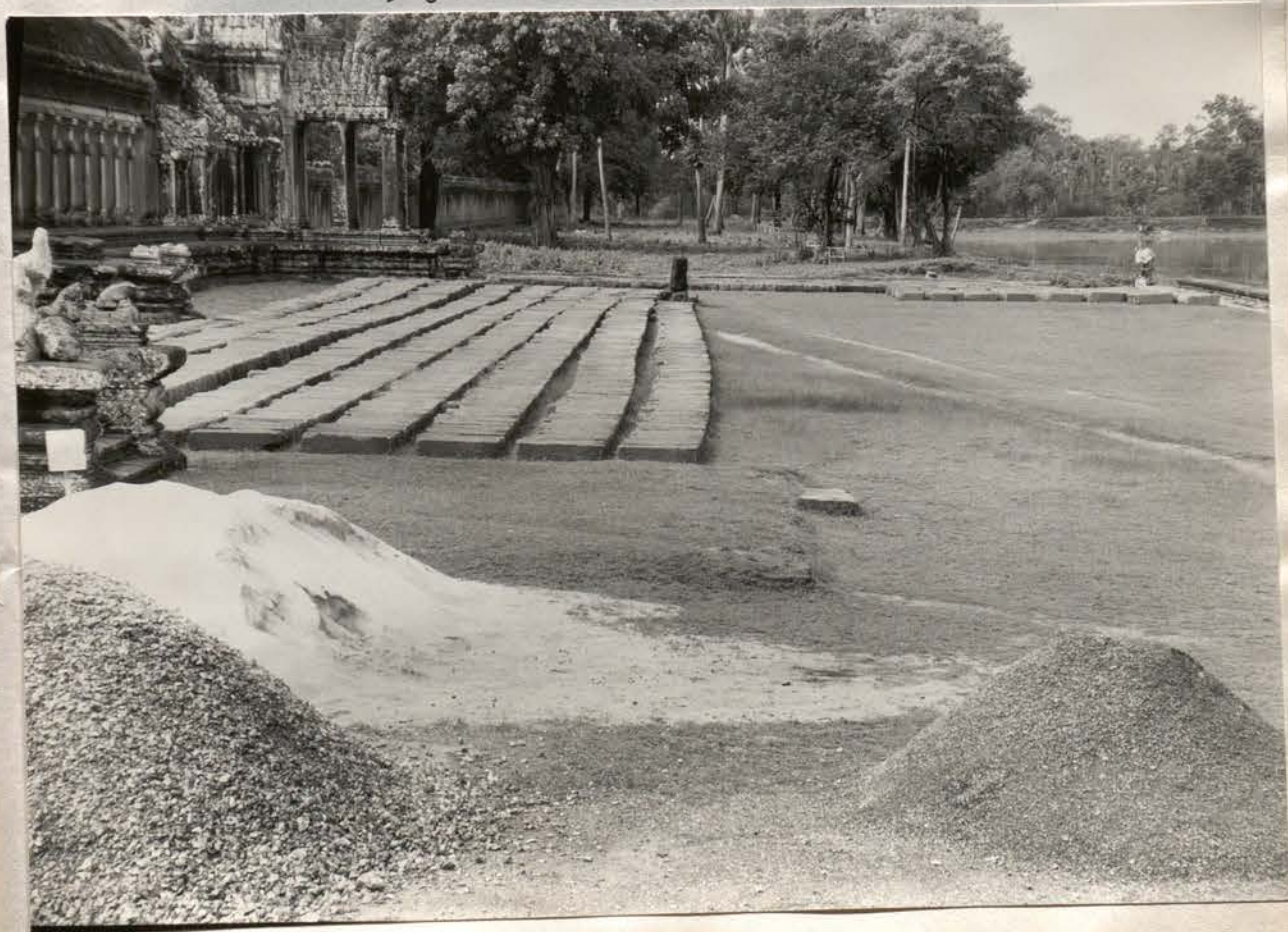
B- Angkor Vat. Chaussée Ouest. Section Est. Blocs déposés rangés devant l'aile Sud du gopura Ouest, pour complément et taille des ancrages. 25 juin 1965 (Ph. 13 x 18 n° 10.161)
