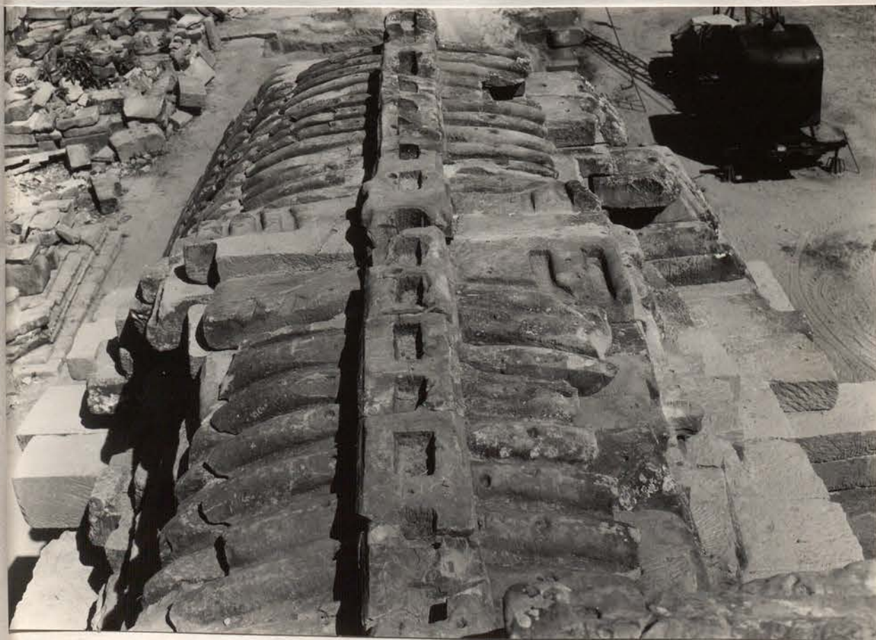
B - Baphuon. Premier Etage. Pavillon axial Est. Ailes Nord. Vue vers Nord. Pose des pierres d'embase des épis de crêtes. 20 janvier 1966 (Ph.13x18 n°10.205)
