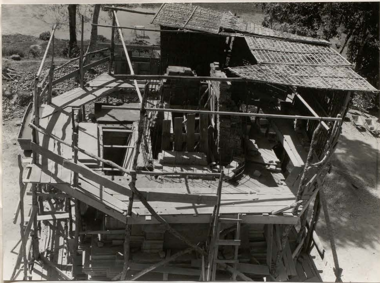
A- Kravan. Tour extrême Sud. 2 e faux étage vu vers Sud. Frette de base du ferrailage coulée avec vide d'allège au-dessus du linteau Est. - 27 janvier 1965 (Ph.13 x 18 n° 10.099).
