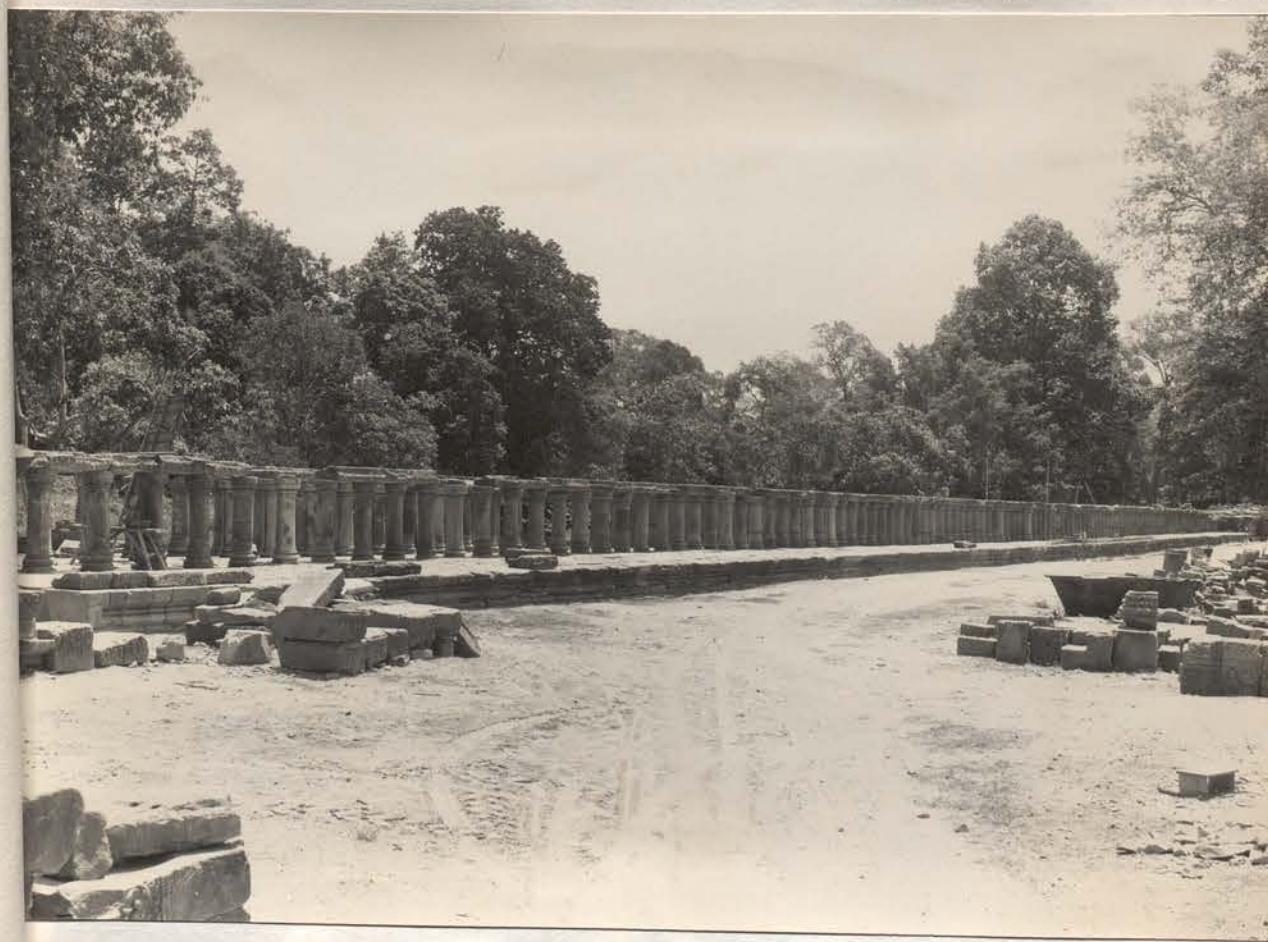
B- Baphuon. Chaussée Est. Section Est. Vue vers Sud-Ouest. Remontage des colonnes. - 29 Avril 1965(Ph.13x18 n°10.130)
